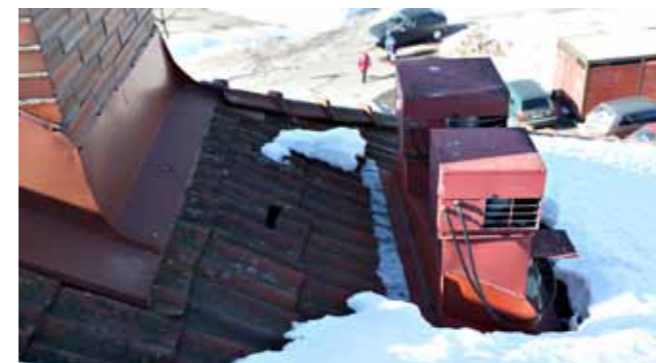
Koneellisen ilmanvaihdon poistoilmatorvet imurei- neen rakennuksen pohjoislappeella.
