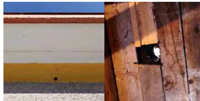
Vintin tuuletus on hoidettu räystäällä olevilla reijillä ja lappeella olevilla peltitorvilla.
