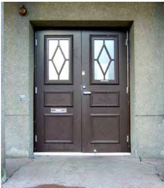
D/2 Kartanon nykyinen pääovi on hämmentävä yhdistelmä synteettisiä materiaaleja, nykyteknikkaa ja historisoivia muotoja. Tämän tyyppiset rakennusosat sopivat huonosti rakennushistoriallisesti arvokkaisiin rakennuksiin.
