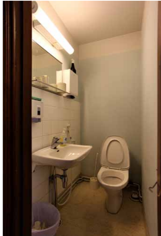
Käyttöveden kalusteet ja laitteistot ovat tyypillisiä 1980-luvun lopun tuotteita.
