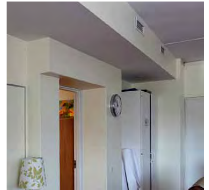
Kotelointeja toisen kerroksen makuuhuoneiden pai- kalle tehdyssä opetustilassa. Kellon kohdalla lienee savuhormi, oven vasemmalla puolella kantava pilari ja katonrajassa ilmanvaihdon kotelointeja.
