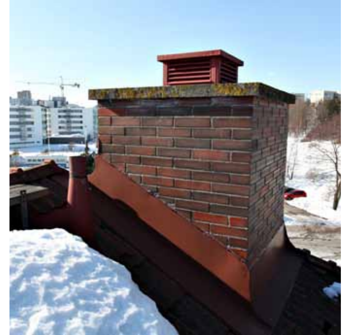
Savupiippujen yläosat on muurattu uudestaan ilmeisesti vuonna 1997. Betonisessa piipunhatussa on vain yksi reikä.
