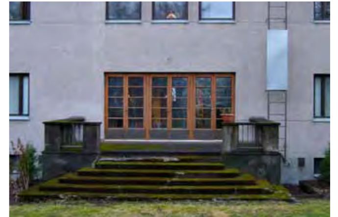
Pohjoissivun lasiovet ja niiden edessä oleva terassi portaineen on säilynyt alkuperäisinä. Betonikaiteiden raudoitukset ovat ruostuneet ja porrasaskelmis-sa on murtumia.
