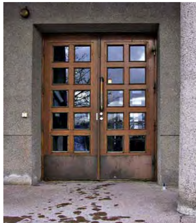
D/2 Kartanon alkuperäinen pääovi vuonna 2001. Alunperin pellavaöljylakatus ovet käsiteltiin Pinotex-Extralla vuonna 1986 (Mattby Gård, Peruskorjaus, Rakennuslitys 1986, Arkkitehtitoimisto Ville Wegelius ky) (Kuva: Espoon kaupunki, Tekninen keskus)
