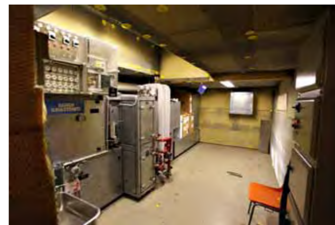
Vuonna 1987 rakennettu ilmanvaihtokonehuone on vintillä. Konehuoneen on suunnitellut Espoon kaupungin tekninen virasto. Ilmanvaihtokone on varustettu lämmöntalteenotol- la, jäätymisvaarakytkimellä, suodatinvahdilla ja lämpöreleillä.
